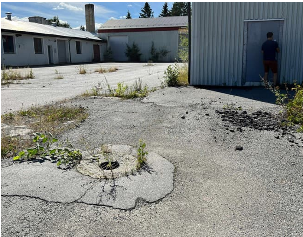
Figur 3 Bilde av kum tilknyttet gammel avløpsnett hvor det på påregnes noe forurensning i bunn av kum og langs eventuelle lekkasjepunkter.
