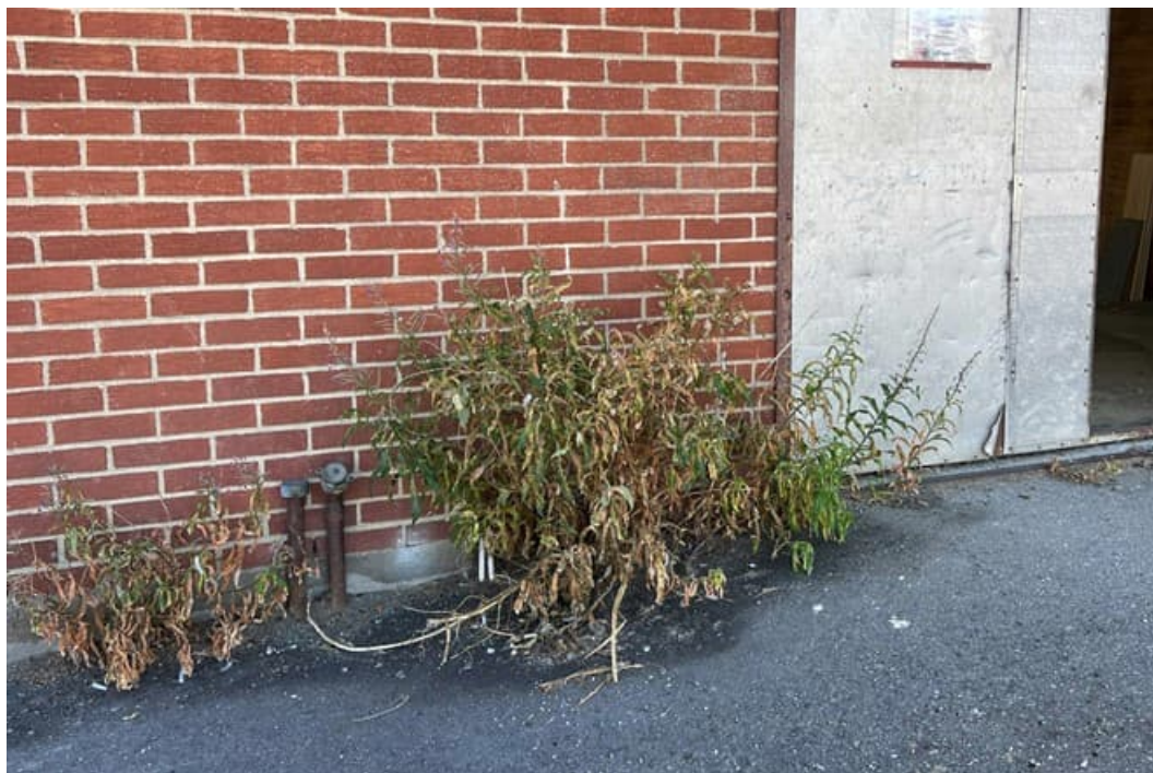
Figur 4 Bilde fra befaring av gamle fyllingsrør til olje. Bildet ble tatt ved en gammel industribygning ved på tidligere område til Årnes fabrikker.
